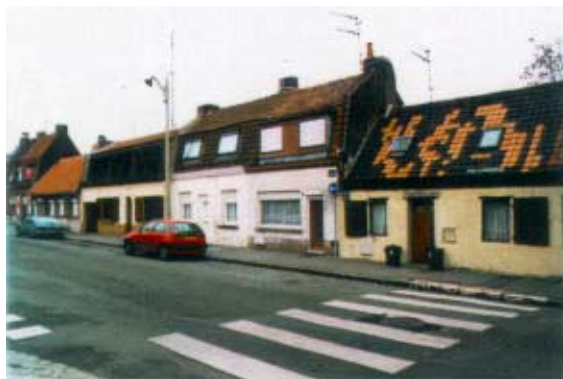
1-11, place Carnot. Maisons ouvrières à rez-de-chaussée. Fragilité du bâti ancien: modification des proportions des percements.
