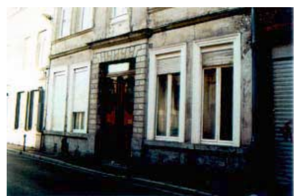
2, rue du Nord. Maçonnerie enduite, soubassement en grès. Encadrement de la porte en pierre avec parement à bossage.
