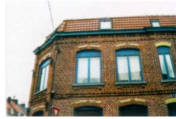
1, rue de la Potennerie. Opération de réhabilitation d'une maison d'angle. Sablage de la brique et rejointoiement ciment. Suppression des impostes vitrées et de la partition du vitrage des fenêtres.
