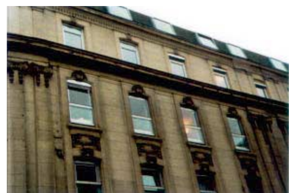
Angle avenue Jean Lebas - rue du général Sarrail. Remplacement des menuiseries bois d'origine par des menuiseries métalliques.
