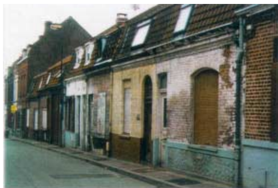
64-72, rue Ma Campagne. Maisons ouvrières à rez-de-chaussée. Fragilité du bâti le plus modeste: succession d'altérations à caractère plus irréversible.
