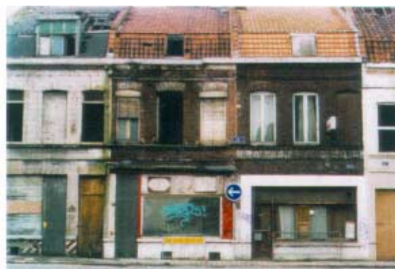
203-205, rue Decrême. Maisons ouvrières à R+1 avec unicité de matériau. Dégradation rapide du bâti lié à l'abandon des commerces à rez-de-chaussée.
