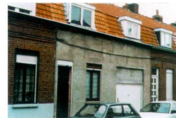
11, rue des Parvenus. Modification des proportions des ouvertures et création d'une porte de garage. Enduit ciment rapporté.
