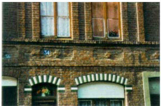
34, rue Saint-Amand. Maison à trois travées. Association des couleurs de la brique émaillée dans l'appareillage en plate-bande.
