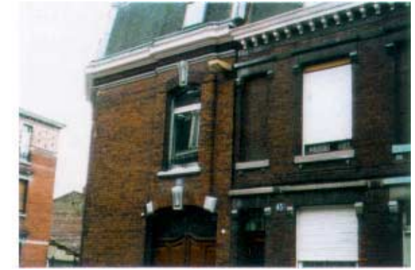
41-43, rue de Valmy. Remplacement des menuiseries bois par des menuiseries plastiques. Adjonction de volets roulants.
